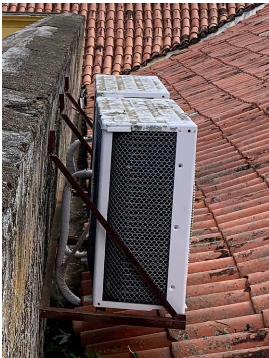
Figura 62 – Sustentação das condensadoras Paulo Parrilha de Figueiredo Filho, 2021.
