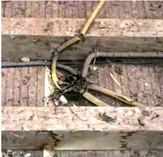
Figura 59 – Caixa de passagem da rede elétrica.
