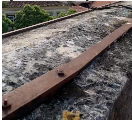
Figura 37 – Água 02, topo da platibanda
