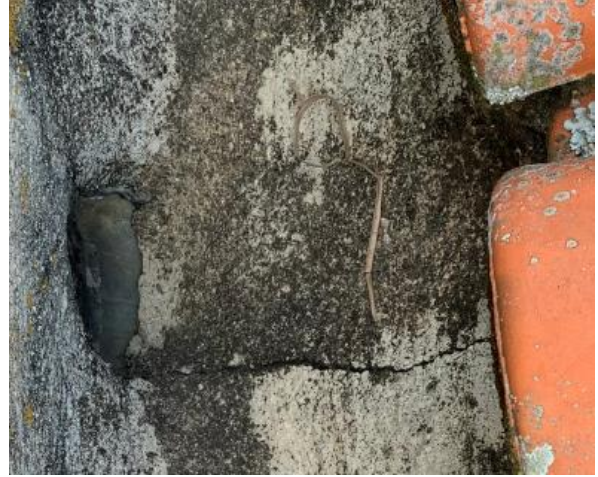
Figura 49 – Trinca da calha
