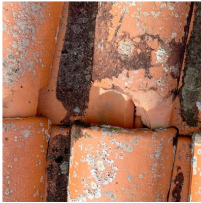
Figura 23 - Água 06 Telha quebrada
