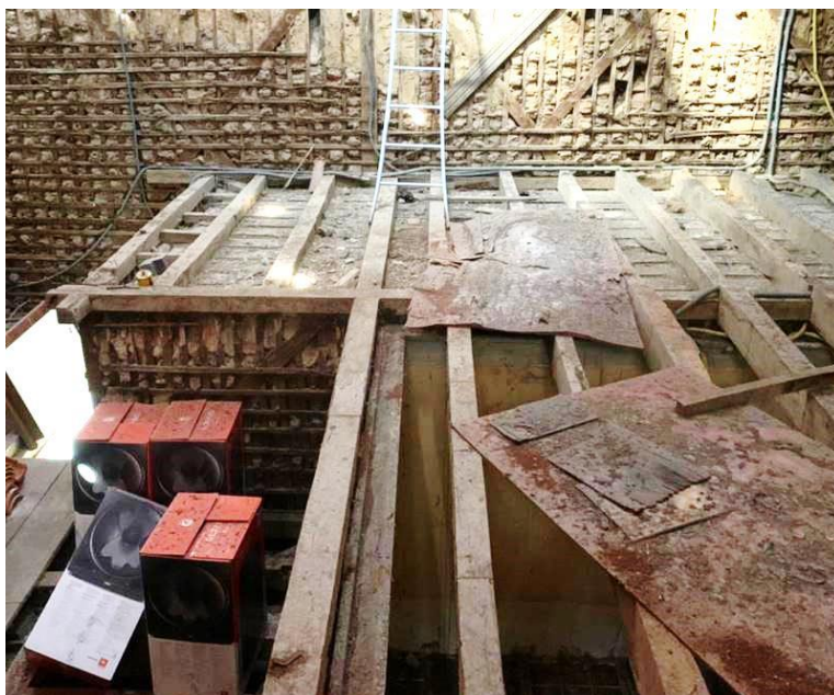
Figura 56 - Ausência do passadiço no trecho do primeiro desnível.
