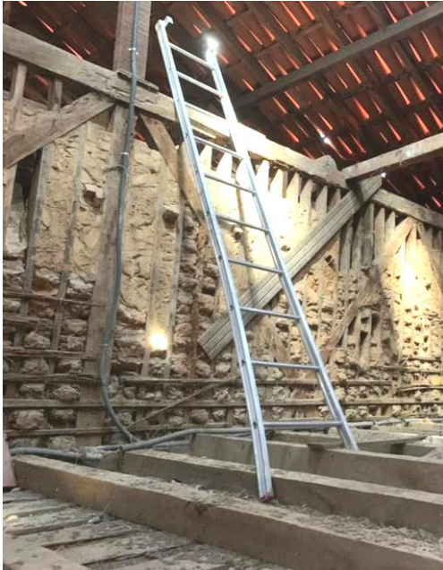
Figura 57 - Fragilidade e risco assentado para usuário da atual escada de acesso ao segundo desnível.
