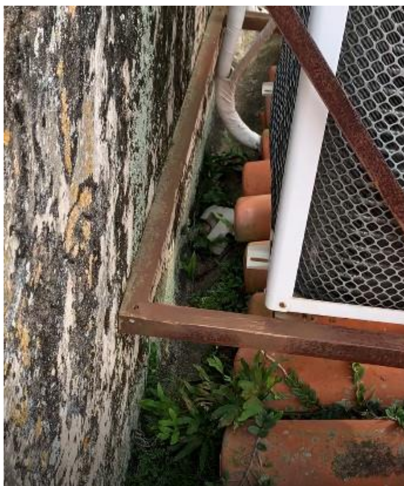
Figura 47 – Detritos e vegetação na calha sob equipamento condensador. Paulo Parrilha de Figueiredo Filho, 2021.
