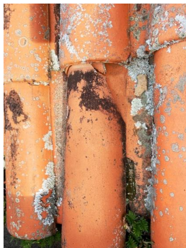
Figura 21 – Água 03 Telhas quebradas e mantidas no local
