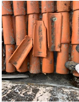
Figura 24 - Água 05 Telhas quebradas e abandonadas no local
