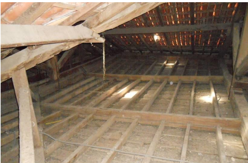
Figura 17 - Forro sob o espigão entre as águas 05 e 06.
