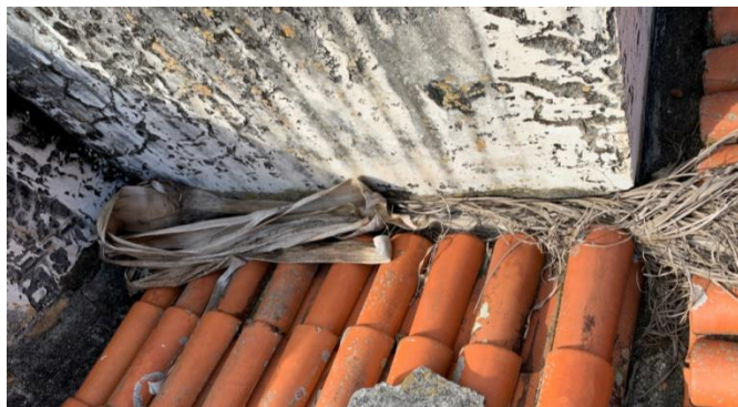
Figura 32 - Água 03, telhado do frontão
