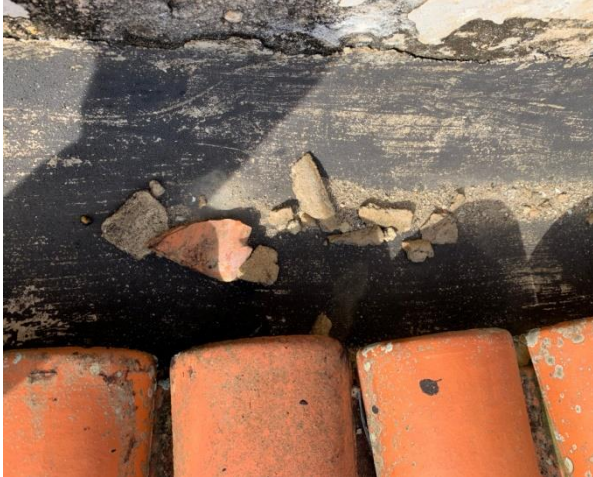
Figura 48 – Descolamento da calha e detritos
