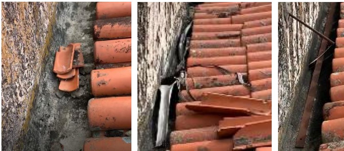
Figura 46 – Detritos dentre da calha. Paulo Parrilha de Figueiredo Filho, 2021.
