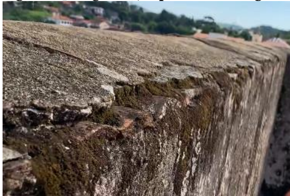
Figura 36 – Água 01, topo da platibanda
