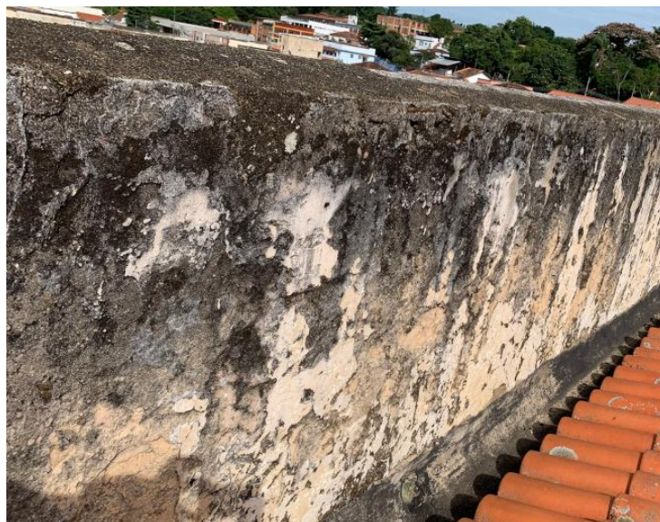
Figura 35 – Água 06, parede interna da platibanda
